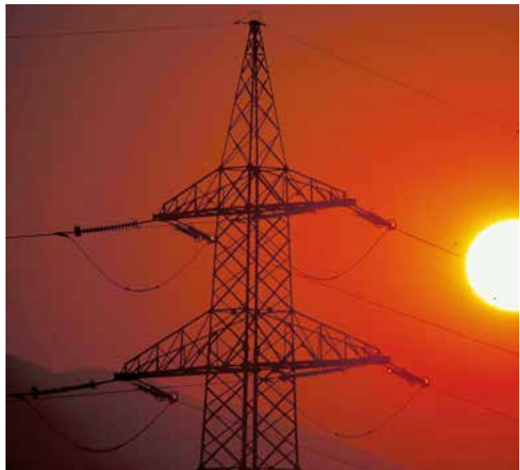
Figura 8. Fuente: Cammesa 2013. Red de Líneas de Alta Tensión 500 KV.
